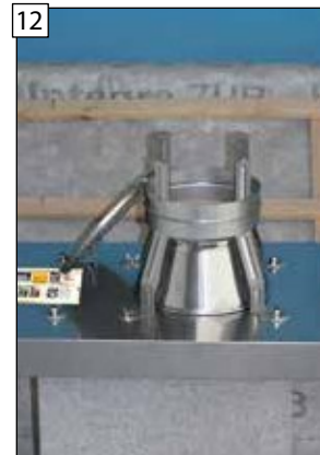
12 Kryt je zajištěn proti pádu a ztrátě ocelovým lankem.
